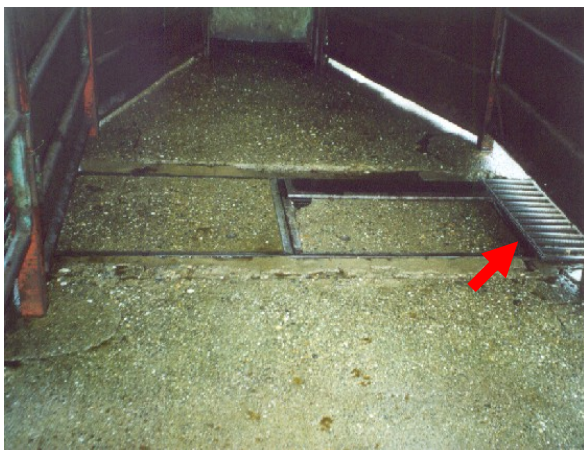
Foto 1: Desagüe a la vista en el pasillo principal de corrales
