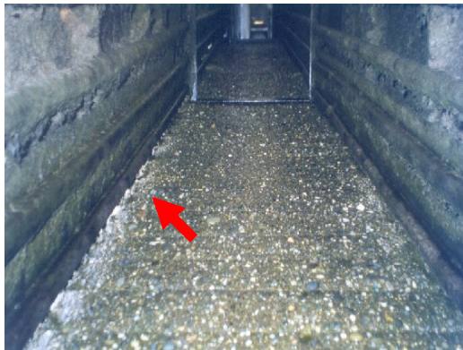
Foto 5: Ángulo entre piso y pared en manga de acceso al cajón de noqueo.
